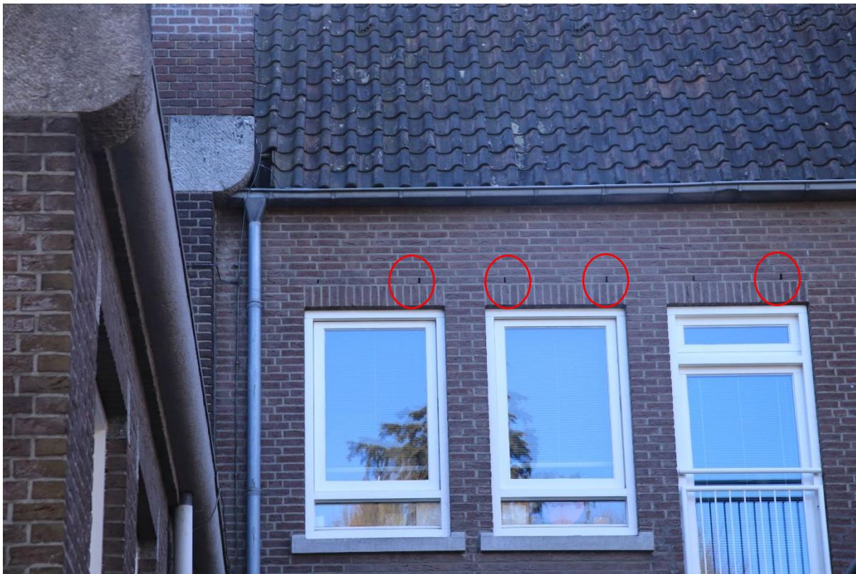
Foto 5: Er zijn meerdere open stootvoegen aanwezig in het huidige gebouw die mogelijk dienst doen als toegang tot de spouw, die vervolgens als vaste rust- en verblijfplaats voor vleermuizen gebruikt kan worden
